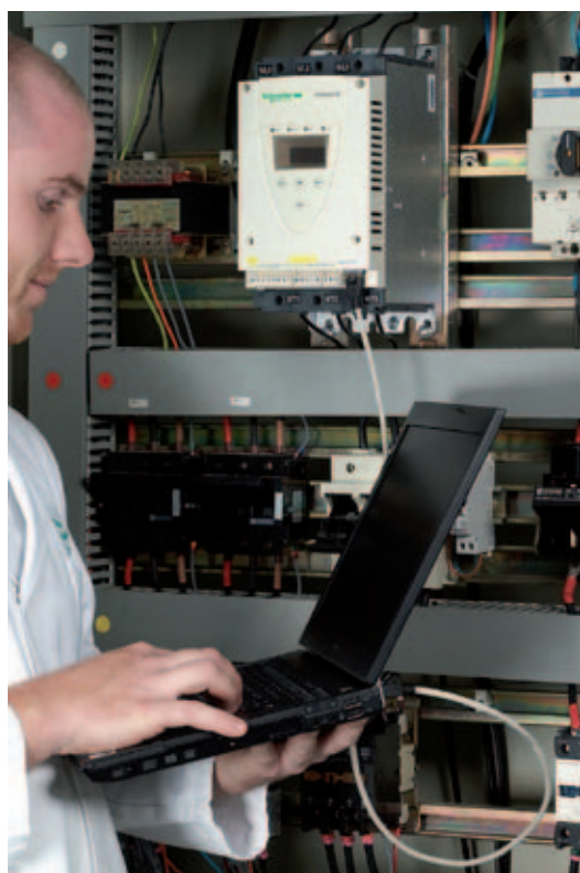
Puesta en marcha del arrancador progresivo ATS 22 con el software de configuración SoMove lite.
