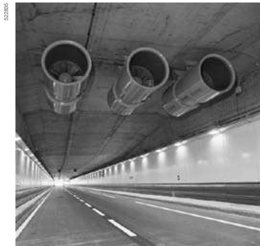
Aplicación de ventilación
