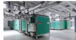
Aplicaciones HVAC e Iluminación >
